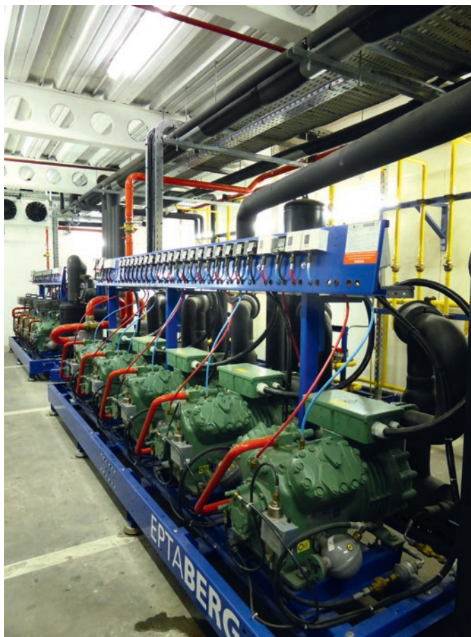
Nuevas centrales EPTABERG de frío positivo y negativo.
