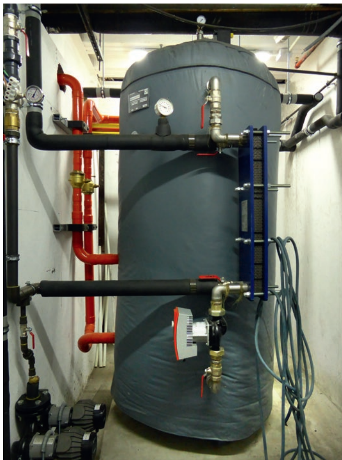
Recuperación de calor: Acumulador de 1000 litros para agua caliente sanitaria.
